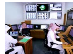
أنظمة سكادا SCADA Systems
