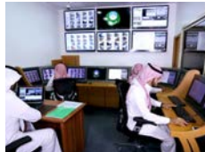
أنظمة سكادا SCADA Systems
